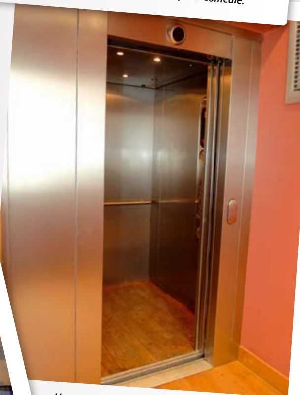
L'ascenseur de l'Opéra Comédie bénéficie d'une nouvelle signalétique.
