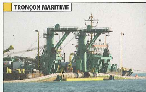
Les tuyaux de polyéthylène haute densité utilisés pour la partie maritime de l'émissaire ont été fabriqués en norvège par tronçons de 550 m. Ils ont été assemblés en mer par une barge de 85 m de long et 35 m de large.
