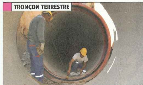
Des tuyaux de fonte de 6 m de longueur et 1,60 m de diamètre forment les 4,8 km du tronçon terrestre de l'émissaire.
