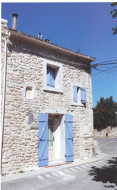
La rénovation des maisons de village, une des clés de la relance du logement dans l'Agglomération.
