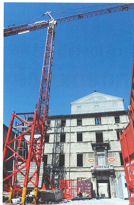
Une grue de 50 mètres de hauteur dans la cour Soulages, à l'entrée du musée.
